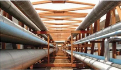
Gas Pipeline Tubería de gas
