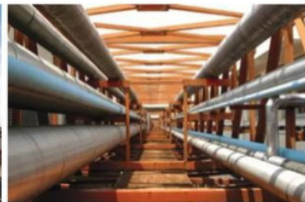
Tubería de gas
